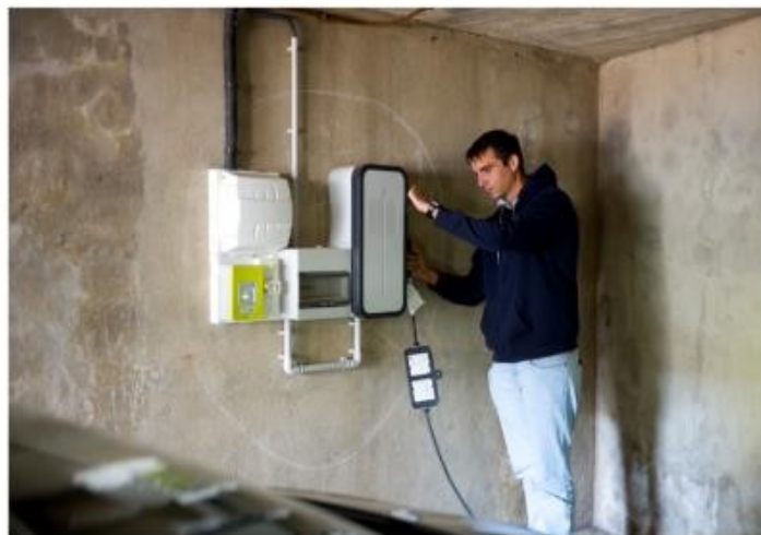
Equipement de l'intérieur d'un box
