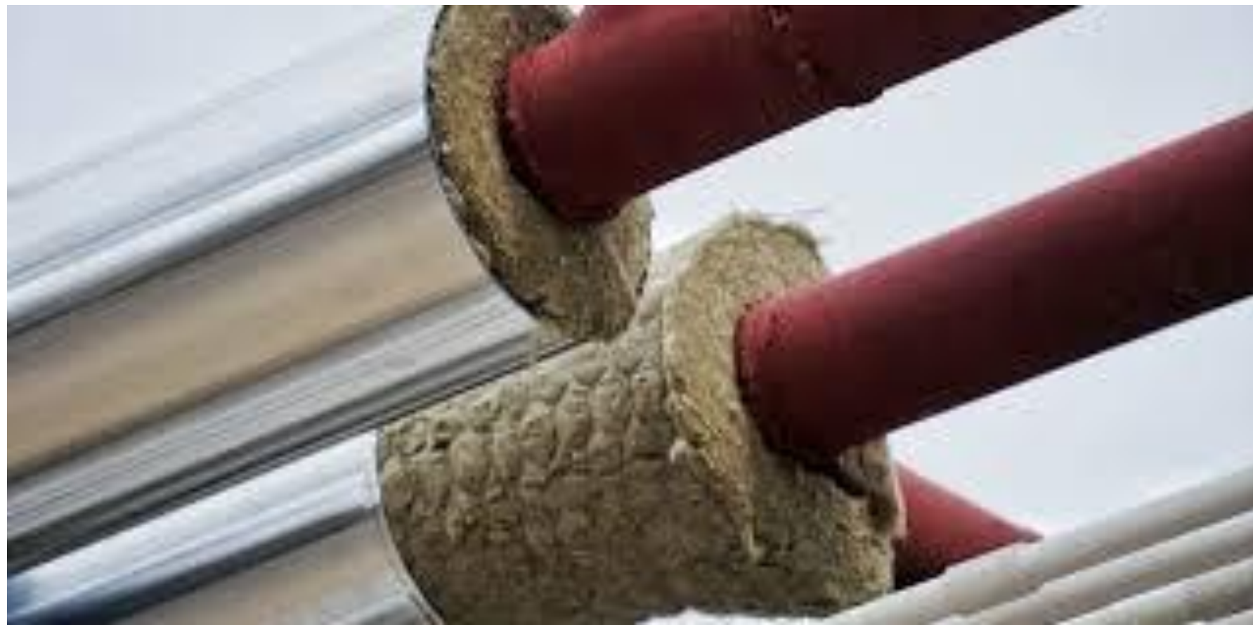
Isolation du circuit de distribution
