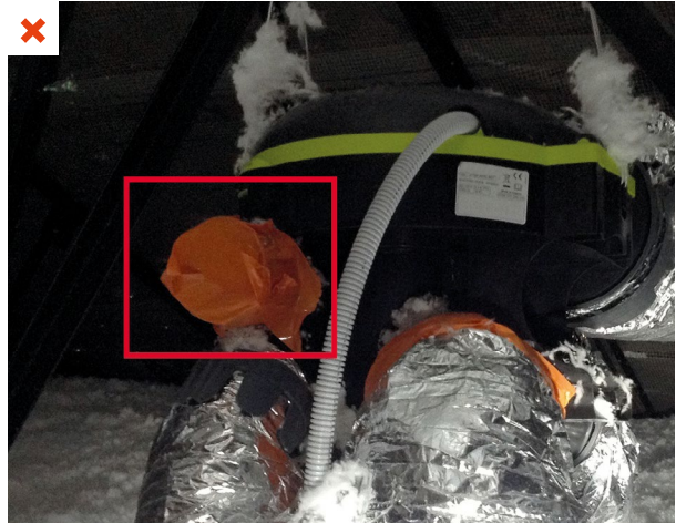
Le piquage non utilisé sur le caisson a été obturé avec de l'adhésif de chantier au lieu d'un bouchon adapté. ©AQC
