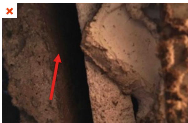
L'espacement entre la paroi support de la bouche d'extraction et le conduit vertical de type Shunt ne permet pas d'assurer une continuité de l'étanchéité à l'air du réseau. @Air efficience
