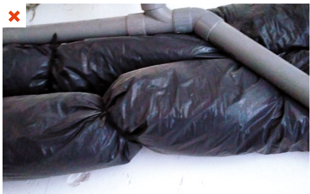
Les colliers installés pour maintenir la gaine souple contre le mur sont trop serrés et réduisent le diamètre de passage de l'air. ©AQC
