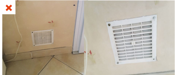
L'ancienne entrée d'air située dans la cuisine n'a pas été obturée lors de la rénovation, ce qui perturbe la bonne circulation de l'air dans le logement. ©AQC
