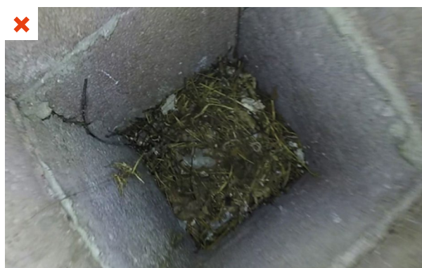
Le conduit existant est obturé par des feuillages (nid d'oiseau), ce qui ne permet pas l'extraction de l'air vicié des logements raccordés en dessous de l'obturation. @Air efficience
