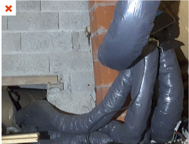
Les réseaux souples raccordés au caisson présentent tous un point bas, favorisant l'accumulation d'eau en cas de condensation. L'installation a été réalisée, dans ce cas, en un temps très court. ©AQC
