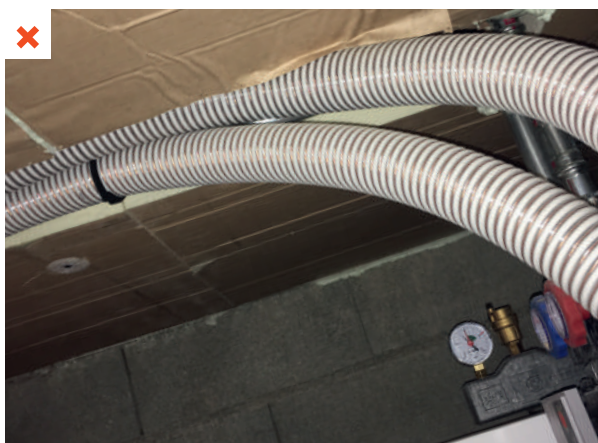
Les tuyaux de transfert des granulés de la chaudière, fixés à la dalle, n'ont pas été dévoyés lors des travaux d'isolation. L'isolation n'est pas totalement continue. ©AQC
