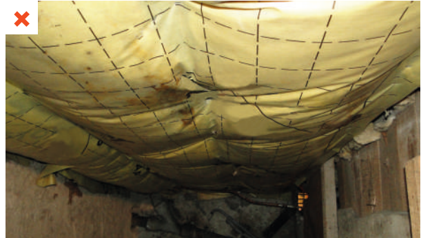
La membrane pare-vapeur est positionnée du côté non chauffé de la paroi (isolation de planchers bois sur cave par rouleaux de laine minérale).
