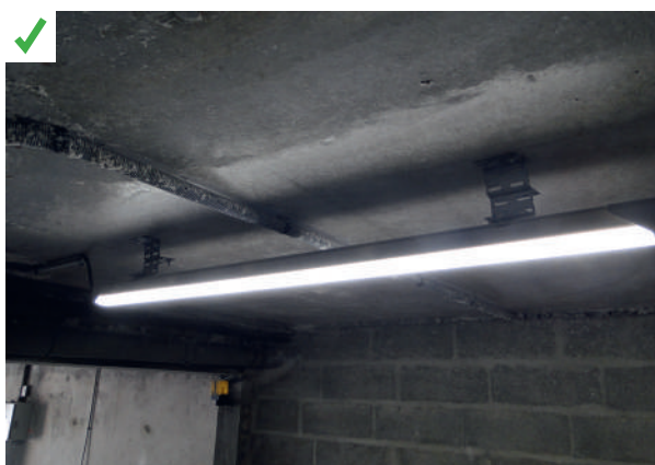
Les luminaires ont été décalés de la paroi pour permettre une projection continue de l'isolant sur toute la dalle. ©AQC
