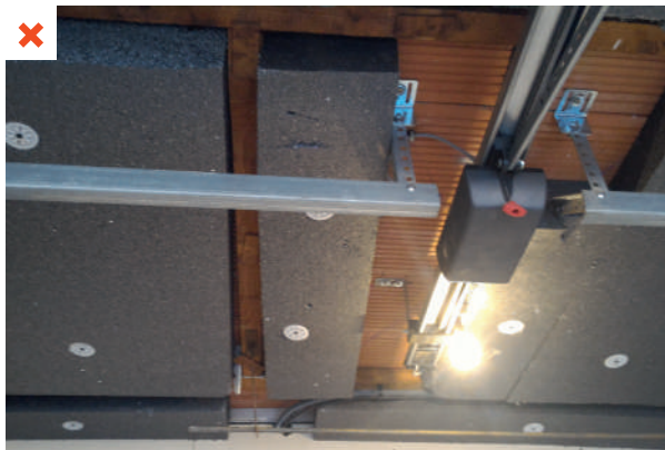
Les rails suspendus de la porte de garage basculante et des pièces de bois fixées au support, non déposés préalablement aux travaux d'isolation, ont gêné la réalisation de celle-ci. L'isolation n'est absolument pas continue. ©AQC
