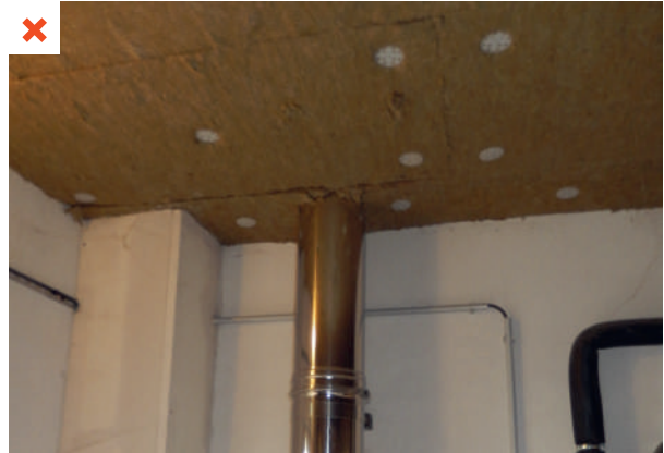
L'isolant non combustible (A1) vient au contact du conduit de fumée métallique. La circulation de l'air autour du conduit n'existe plus. La ventilation de la gaine coupe-feu est obturée.
