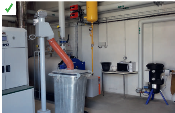
Installation d'un poste de contrôle d'humidité des plaquettes dans le local chaufferie composé d'un micro-onde et d'une balance type pèse-lettre. ©AQOC
