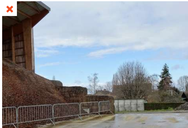
Une partie du stockage du combustible se trouve à l'air libre, en dehors de l'aire protégée des intempéries. ©AQOC
