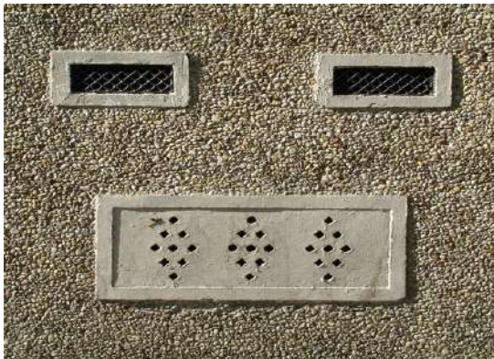
← Les grilles de ventilation
