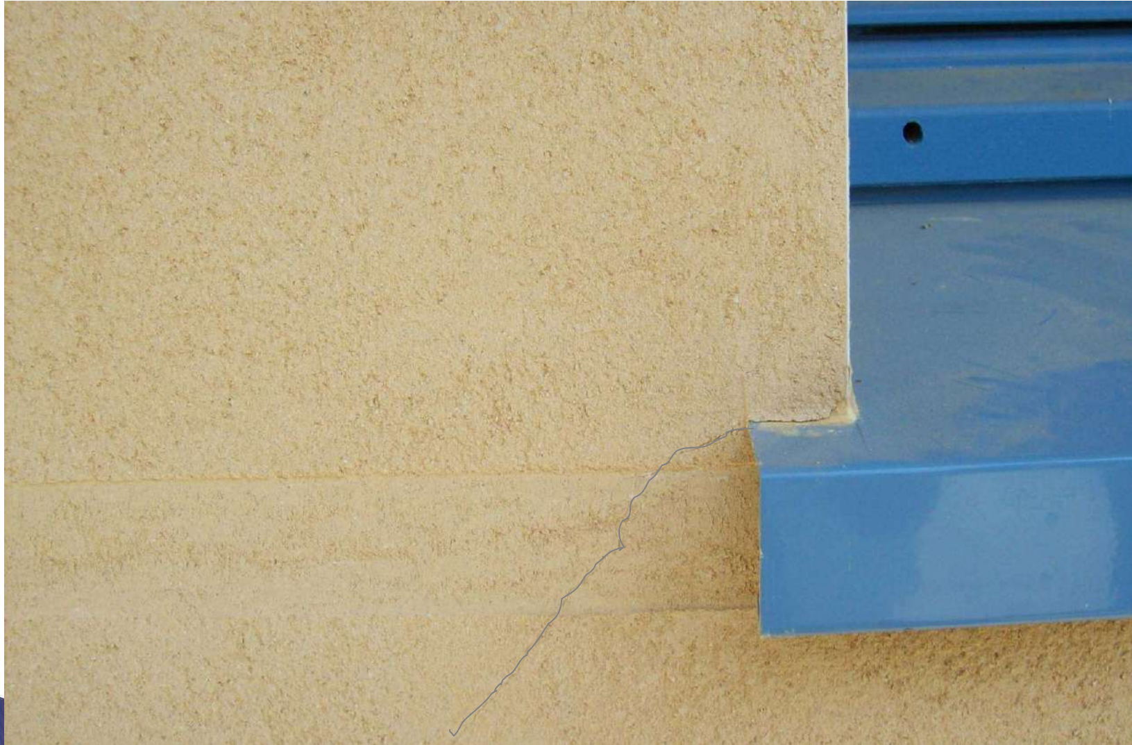
Appui de fenêtre non-conforme
