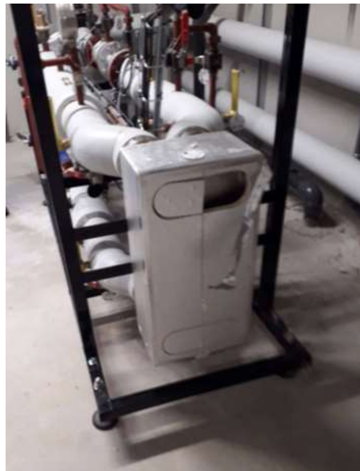
Poste de livraison
